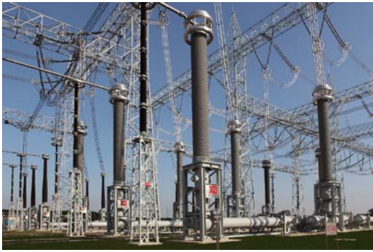
荆门 1000 千伏变电站
